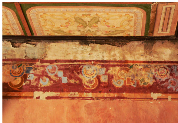
Hình 5: Đường viền hoa văn đầu tường bị bong tróc do thấm nước tại nhà cổ Bình Thủy-Cần Thơ (Người chụp: Hạnh Linh, tháng 03/2011)
