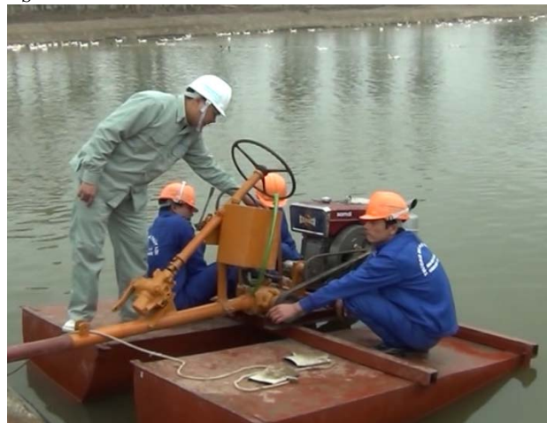
Hình 3.1 Lắp đặt hệ thống máy hút bùn mini tự hành tại ao, hồ [3]
