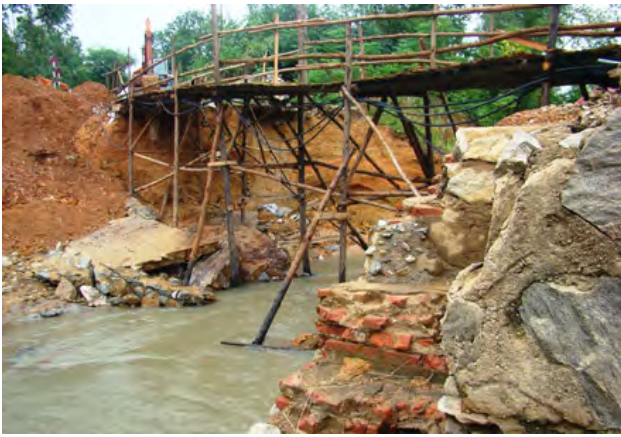
Đập Phân Lân (Vĩnh Phúc) bị vỡ ngày 3/8/2013 Hình 1- Ảnh một số đập bị vỡ
