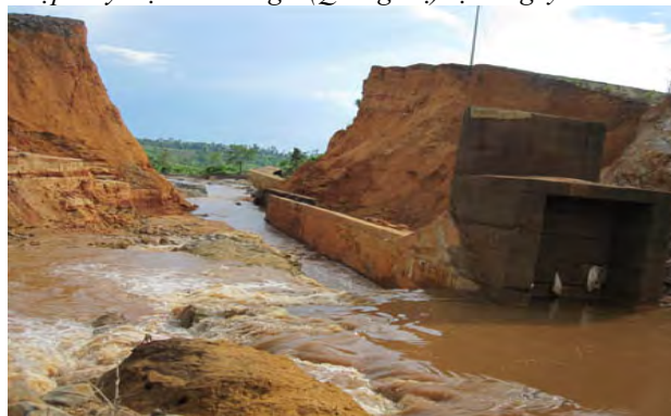
Đập Iakrel 2 (Gia Lai) bị vỡ ngày 12/6/2013
