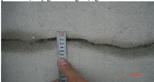
Hình 2: Hình ảnh vết nứt bê tông bản mặt công
