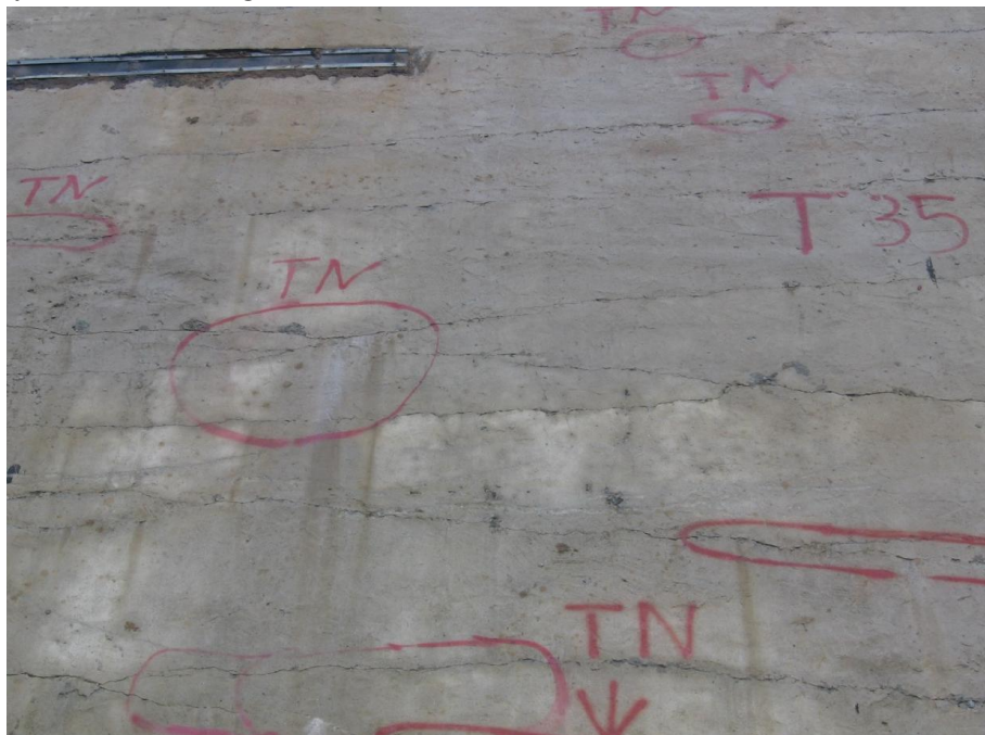
Hình 1: Hiện trạng nứt bản mặt công trình Hồ chứa nước Cửa Đạt
