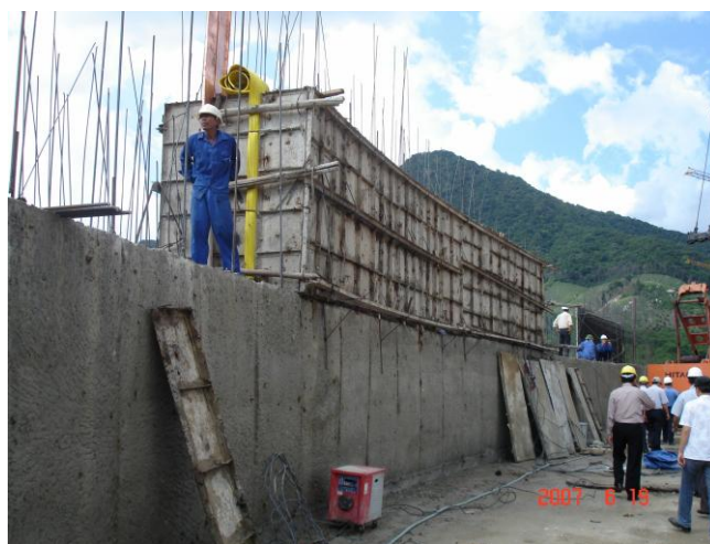
Hình 3. Đổ bê tông t- ờng chống thấm và xử lý khe nứt co ngót bằng Sikadur
