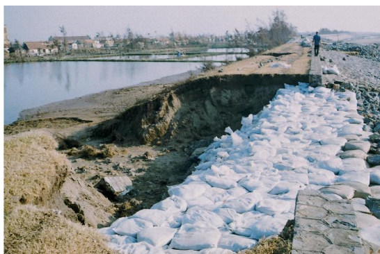
Hình 22. Sóng tràn qua đê và hạ thấp cao trình đê tạo lỗ vỡ
