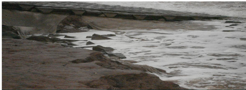
Hình 2. Dòng ven và sóng gây xói, mái đê và kè phía biển dưới chân kè
