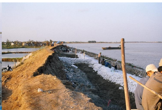
Hình 21. Toàn bộ mặt đê bị phá sập
