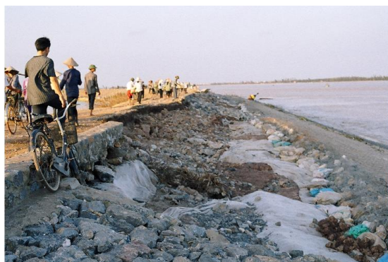
Hình 20. Phần đá lát khan bị sóng đánh hư hỏng toàn bộ
