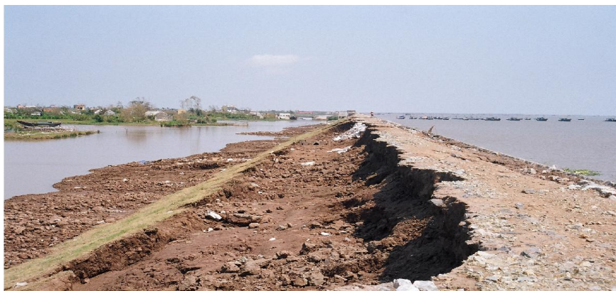
Hình 7. Sóng tràn sạt mái đê phía trong đồng
