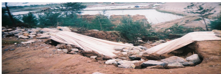
Hình 4. Sóng leo lớn gây nước tràn qua mặt đê dẫn đến xói mặt đê và mái đê phía sau
