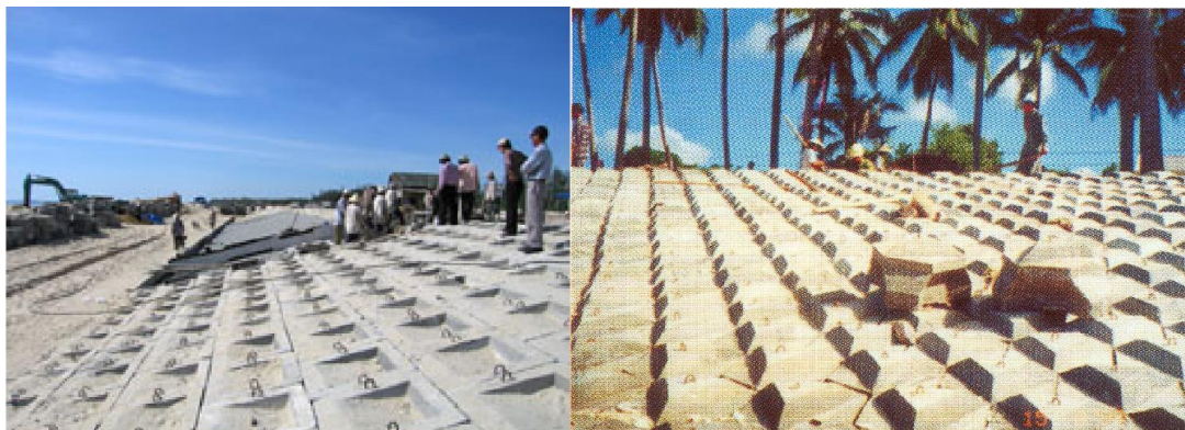
Hình 12. Thâm bê tông tự chèn P.Đ.TAC
