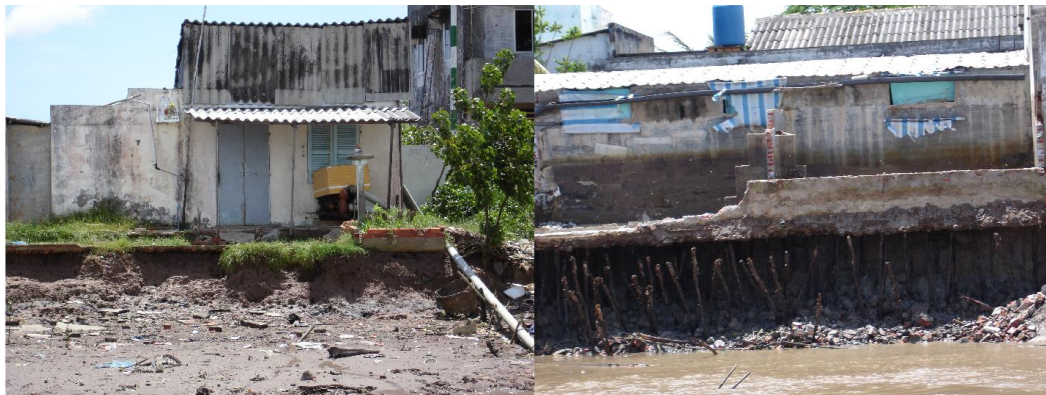
Hình 2. Hình ảnh sạt lở bờ sông khu vực thị trấn Gành Hào
