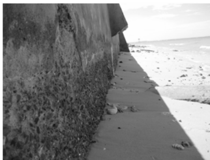
Hình 13: Chân kè Mỹ Tường đang bị xói mòn thủng
