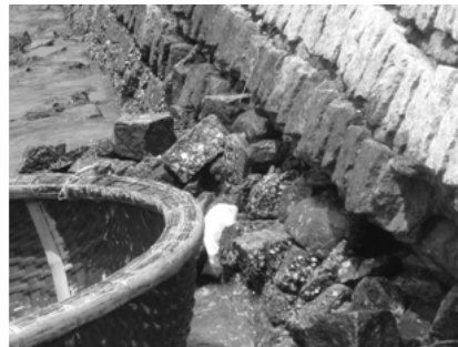
Hình 14: Hư hỏng mặt kè ven biển do sóng đánh mạnh gây vỡ
