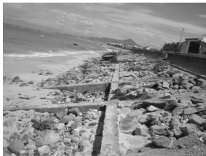
Hình 12: Kè Mũi Hiệp đang thi công do sóng lớn gây xói lở mặt, bị vỡ
