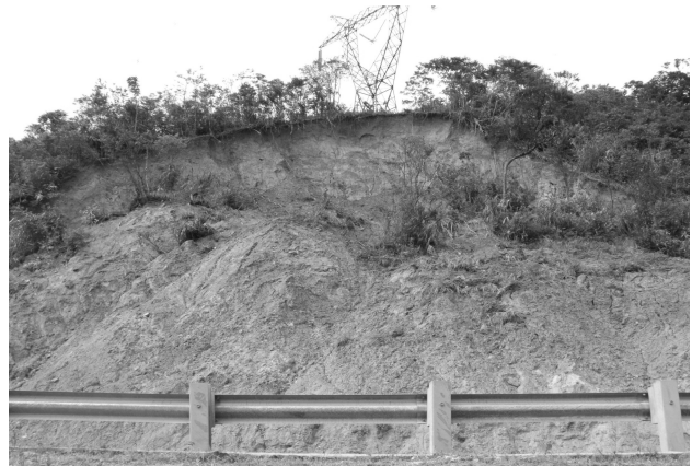
Hình 2. Trượt taluy đường Hồ Chí Minh tại đèo Lò So, Quảng Ngãi (mùa lũ năm 2010)
