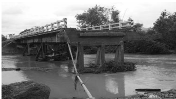
Hình 6. Cầu Ngô La tại xã Canh Vinh bị dòng nước lũ năm 2009 cuốn trôi
