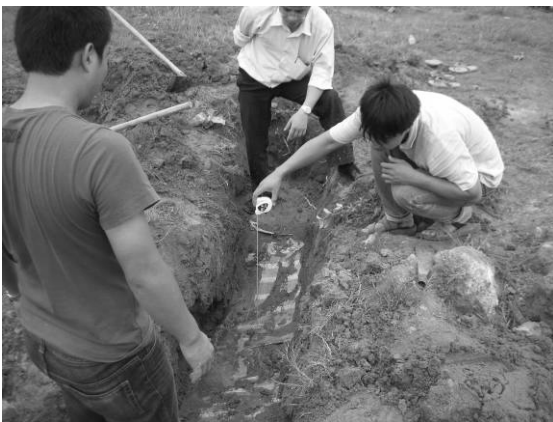
Hình 12. Kiểm tra lún của hào sau thời gian thi công 6 tháng
