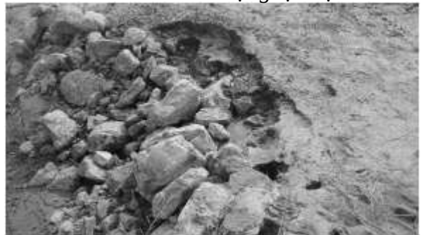
Hình 11. Kè đá cũ bị phá hỏng
