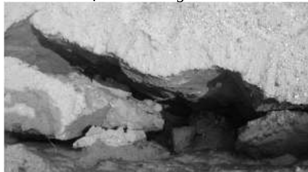
Hình 10. Vết nứt rộng tại mặt nền
