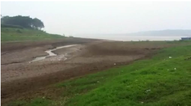
Hình 6: Kênh dẫn vào cống Cẩm Đình bị bồi lấp nghiêm trọng (Lê Văn Hùng, 2013)
