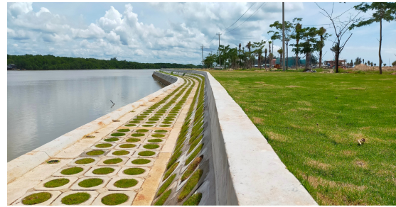
(b) Kè bờ sông Ray, Phước Thuận, Xuyên Mộc
