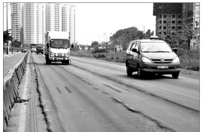
Hình 2: Biến dạng trượt của lớp mặt đường bê tông asphalt đường Đồng Văn Cống - Liên TL25B, Quận 2 - TP. HCM
