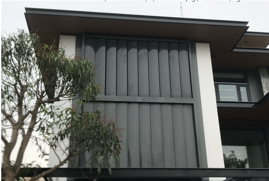
Hình 8. Lam chắn nắng 3 chế độ lúc xếp gọn - công trình Hải An, Hải Phòng
