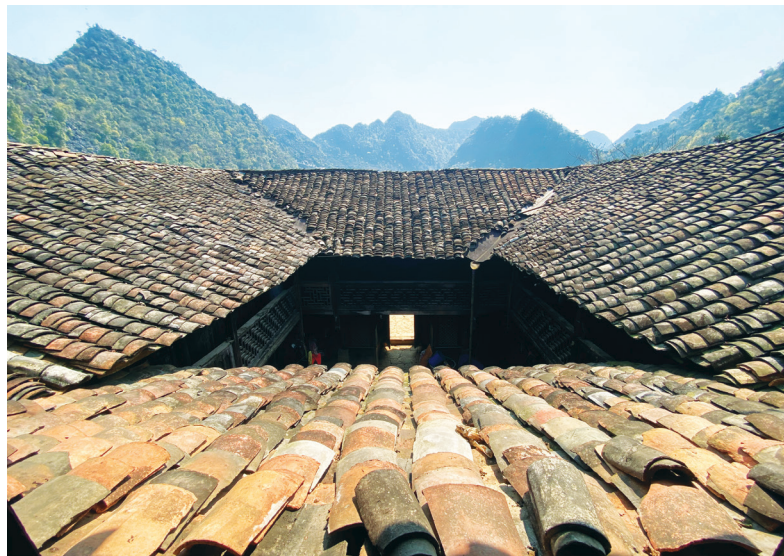
Ngôi nhà cổ họ Vũ bản Lũng Táo - Đồng Văn Tường, mái và kết cấu nhà đang xuống cấp nghiêm trọng
