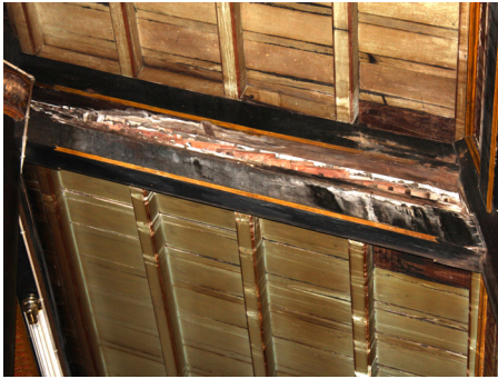
Vì mái chùa Kom Pong, phường 1, TP Trà Vinh đang xuống cấp
