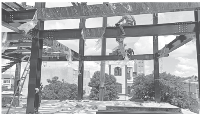
Hình 1. Khung thép nhà dân dụng thấp tầng
