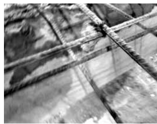
Thép sàn chưa bị ăn mòn (gần khu vực ăn mòn)
