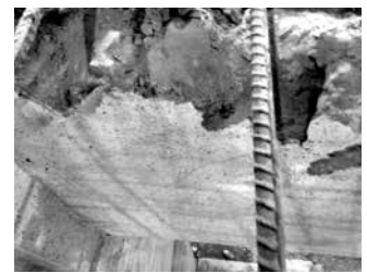
Vết nứt xuất hiện phía đầu dầm
