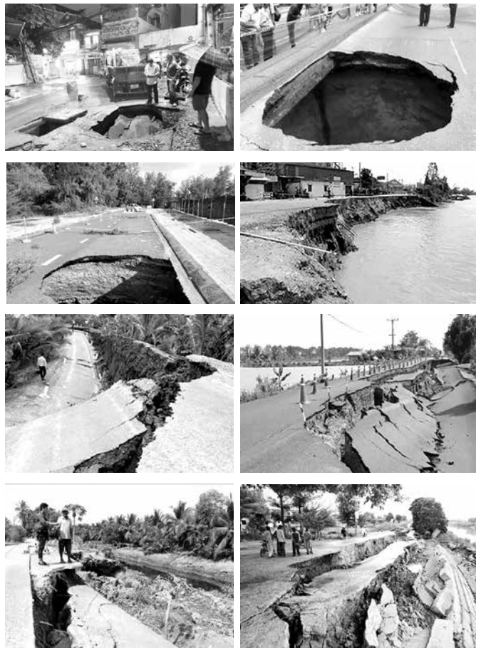
Hình 3. Một số hình ảnh “hố sụp” do ảnh hưởng áp lực nước lỗ rỗng trong nền đường
