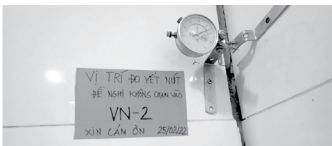
Nhà xưởng KCN Châu Sơn Hà Nam Khảo sát hiện trạng nứt tách tường
