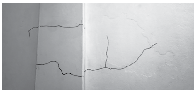
Nhà 423 Kim Mã- Ba Đình - Hà Nội (Hư hỏng do công trình xây dựng gần đấy gây ảnh hưởng)
