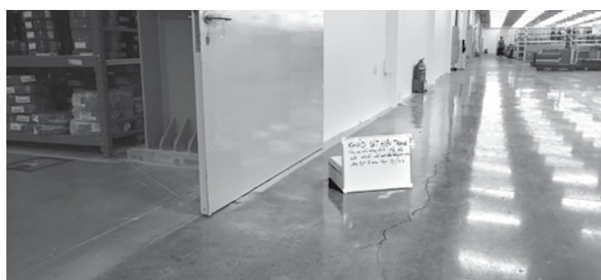
Nhà xưởng KCN Châu Sơn Hà Nam (Hư hỏng do nền đất yếu và xây dựng bể xử lý nước thải liền kề)
