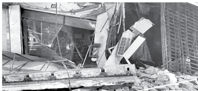
Nhà 62 Quang Trung- Sơn Tây - Hà Nội (Sập đổ do nhà bên cạnh đào móng thiếu biện pháp)
