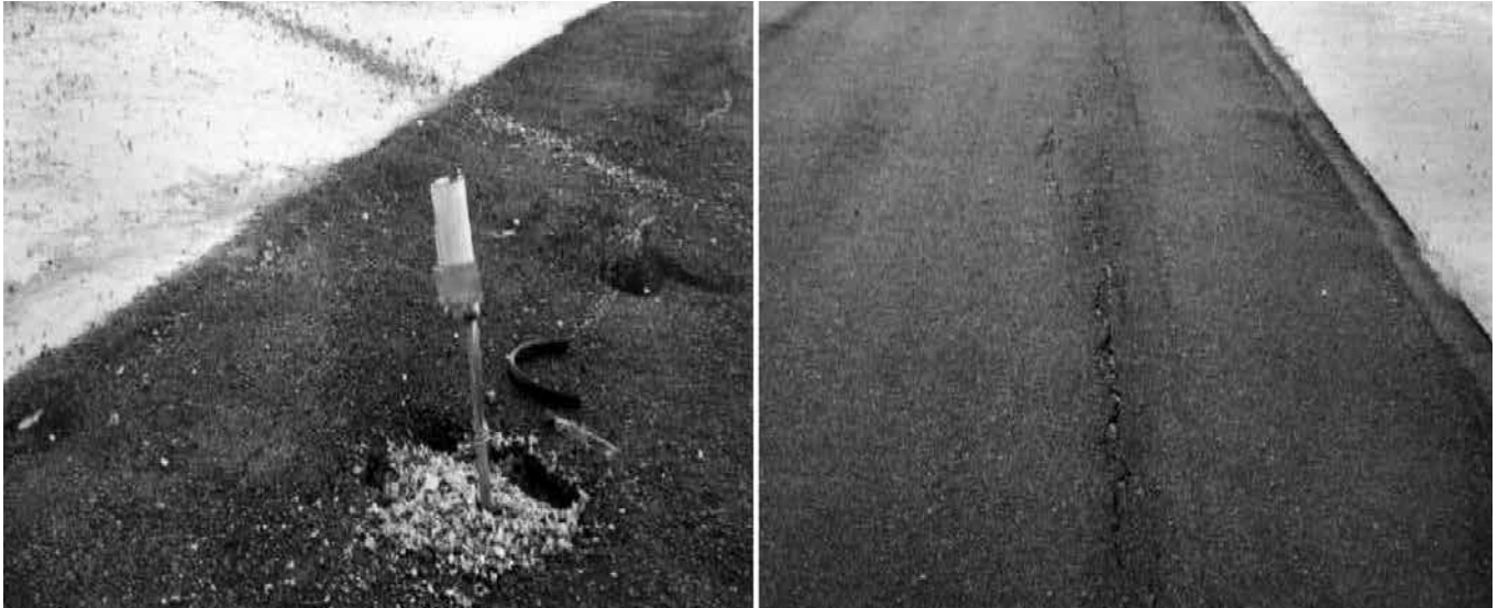
Hình 1. Hình ảnh vết nứt, hố sụt lún bãi sau kè Công trình Cầu cảng 10.000DWT của Công ty TNHH MTV 128 – Quận chũng Hải quân
