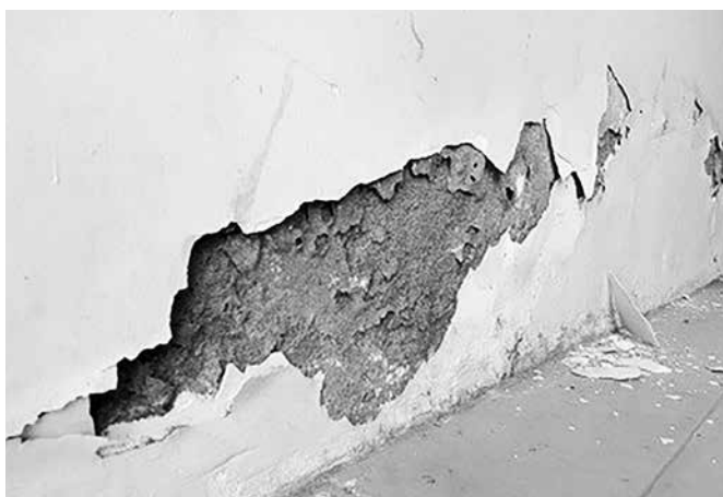
Hình 7: Bong dột bề mặt tường
