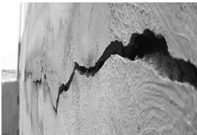
Hình 3: Nứt tường chịu lực
