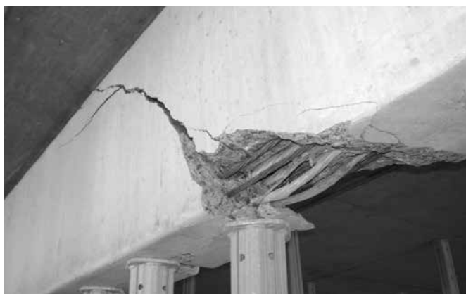
Hình 5: Nứt, vồng dầm bê tông
