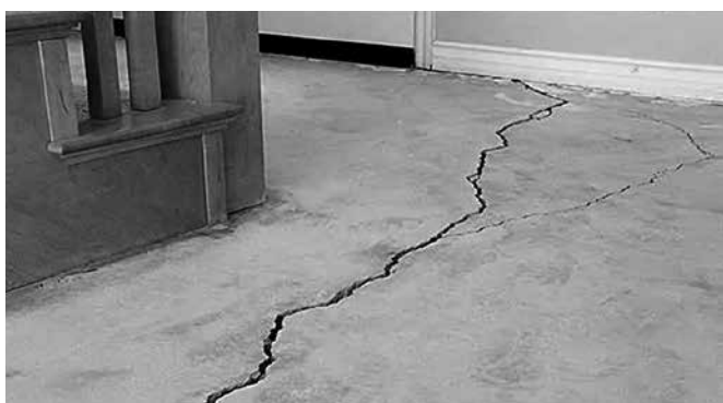
Hình 4: Nứt kết cấu sàn bê tông
