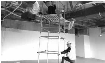
Khảo sát hiện trạng nứt kết cấu dầm sàn
