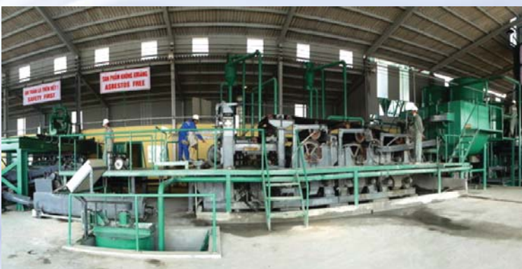
Dây chuyền sản xuất tấm lợp không Amiăng do Viện Công nghệ sản xuất (Sản phẩm của Đề tài cấp Nhà nước KC.06.15)
