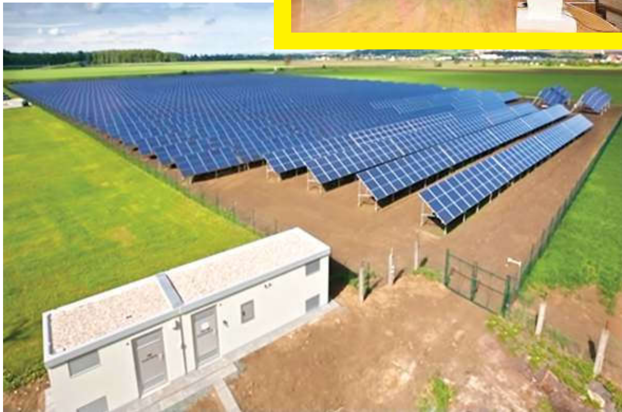
Nhà máy điện năng lượng mặt trời ĐH Cửu Long
