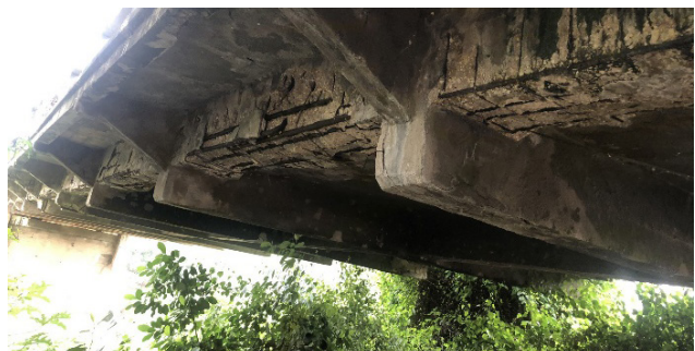
Hình 3: Dạ cầu bị gỉ sét lộ sắt bên trong.
