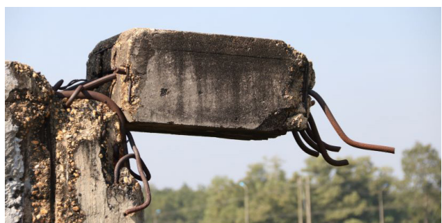
Hình 4: Trụ cầu bị gãy
