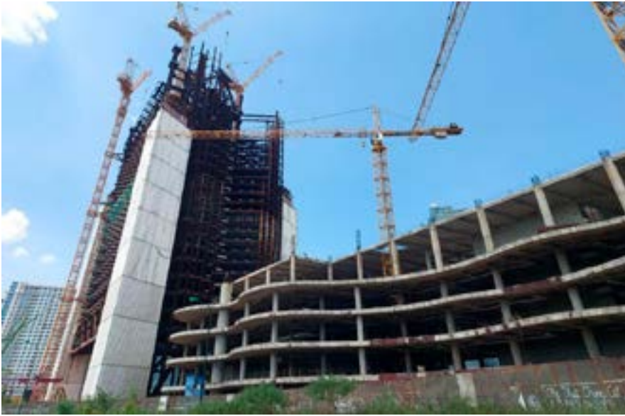
Hình 2. Dự án VietinBank Tower, Tây Hồ, Hà Nội, chưa hoàn thành sau 13 năm khởi công
