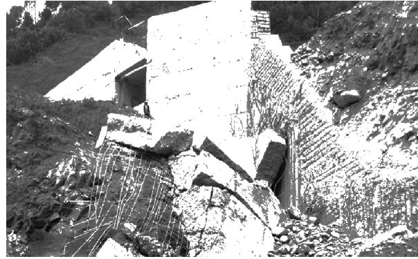
Hình 1.2. Đập thủy điện Đắk Mek 3 bị vỡ, sập
