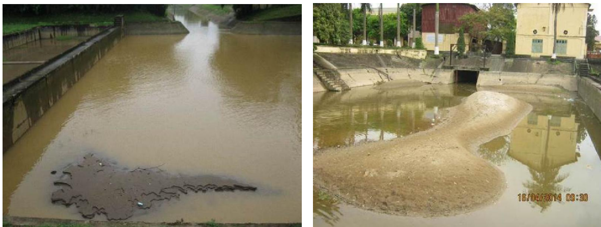
Hình 2: Hiện trạng bồi lắng tại bể xả trạm bơm Phù Sa (08/2014)
