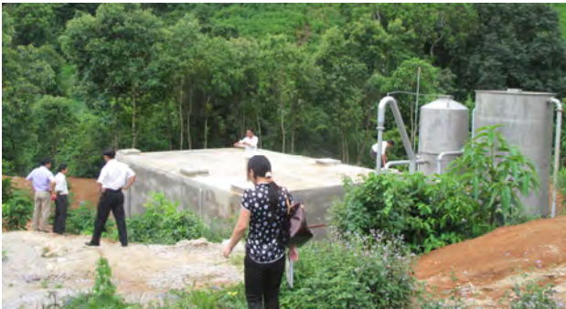
Hình 3: Cụm xử lý nước sử dụng bể lọc tự rửa nằm ở khu xa dân cư, không có nguồn điện năng
