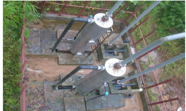
Hình 2: Cụm thiết bị tự rửa không van tại trạm xử lý nước xã Tô Mậu – Lục Yên – Yên Bái
