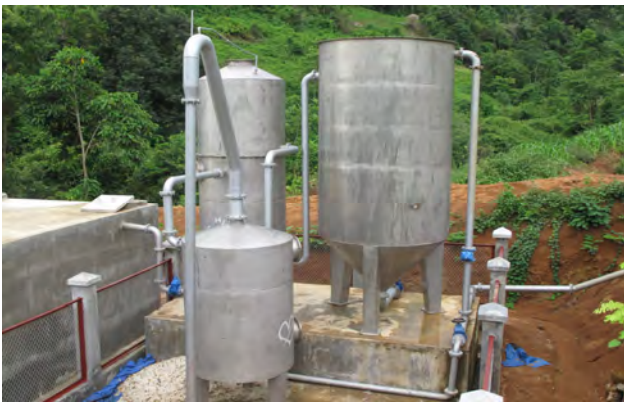
Hình 4: Cụm thiết bị xử lý nước công suất 10\text{m}^3/\text{h} có bể lọc tự rửa
