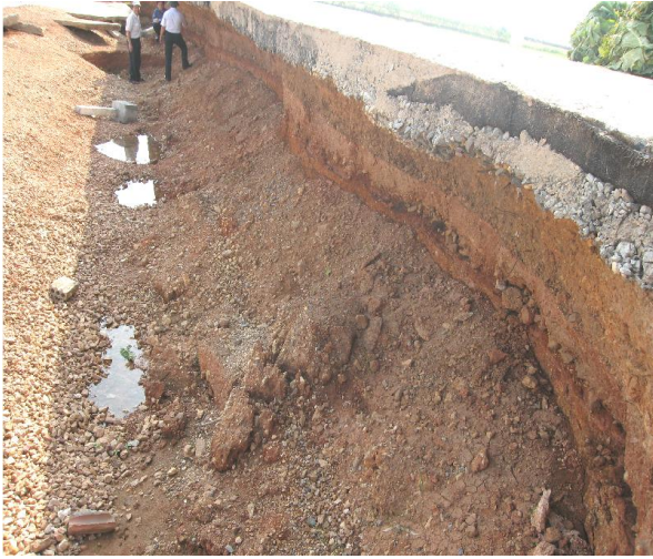
Hình 2. Các lớp đất đắp bị phân lớp và đất đắp đập bị sạt trượt
