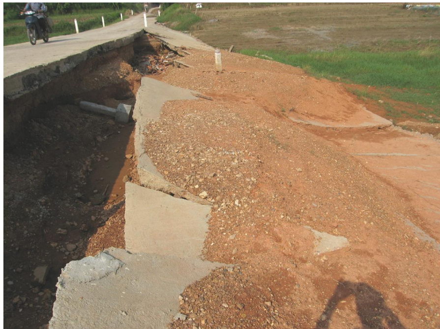
Hình 1. Các tấm bê tông mái hạ lưu bị sạt trượt
