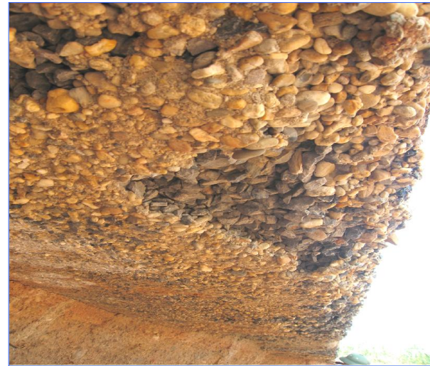
Hình 3. Mặt dưới tấm bê tông mặt đường tuyến ngầm
