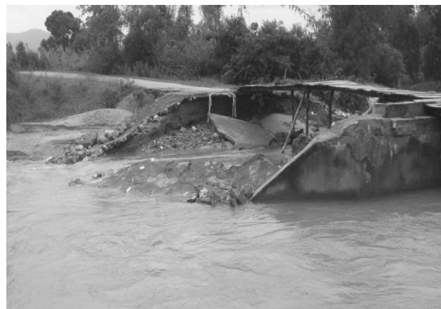
Hình 2. Mặt cầu (Hà Tĩnh) đã bị trôi nên phải bắc cầu tạm để đi lại
