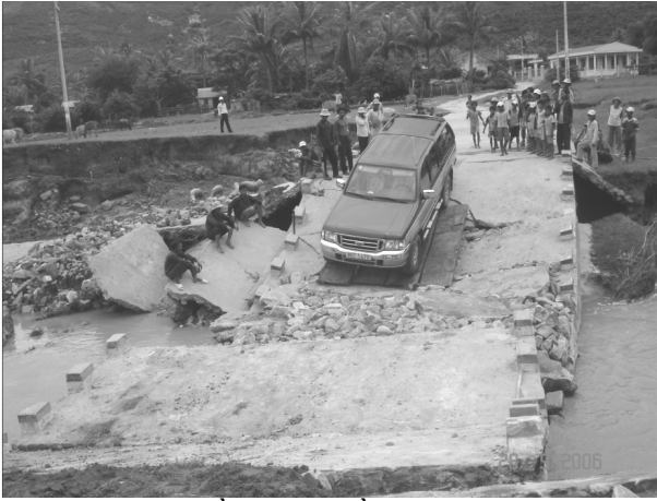
Hình 3. Cầu Xóm Đèn (Quảng Ngãi) bị sập do trụ bị phá hoại
