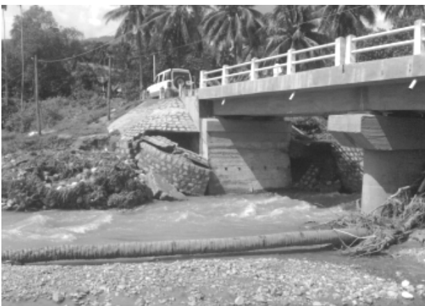
Hình 1. Hư hỏng kè ở mố cầu (cầu Gia Thiều – Quảng Ngãi)
