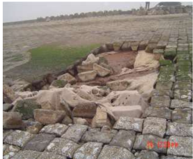
Ảnh 1: Kè đê biển bị sập do sóng
