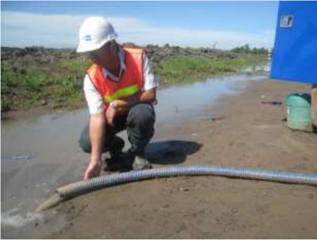
Hình 9: Ống xả máy bơm hút chân không.
