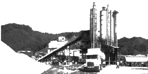
Hình 4.1. Trạm trộn BTĐL
