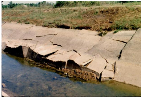
1c. Mái kênh bị sạt do nước rút
