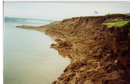
1b. Bờ sông Đà bị sạt lở – Hạ lưu thủy điện HB
