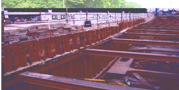
Hình 2. Bảo vệ mái hố móng hầm Kim Liên bằng tường cừ nhiều tầng chống
