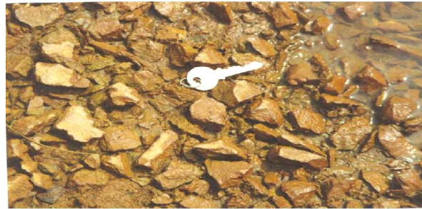
Hình 2. Cống An Hạ - Bình Chánh - Sau 3 năm
