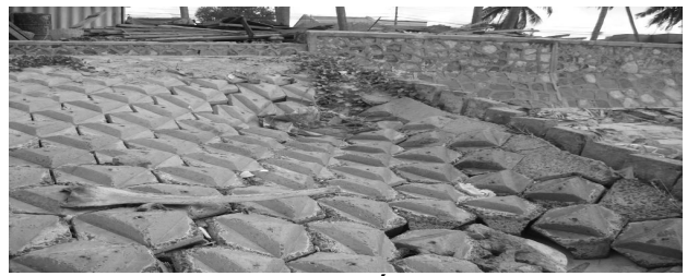
Hình 3.3: Mái kè Hàm Tiến – Mũi Né bị sụt lún
