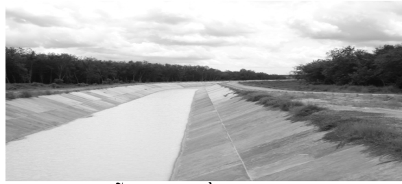
Kênh dẫn nước hồ chứa Phước hòa (gói 1 C)- Nguồn vốn ADB – 9/2011
