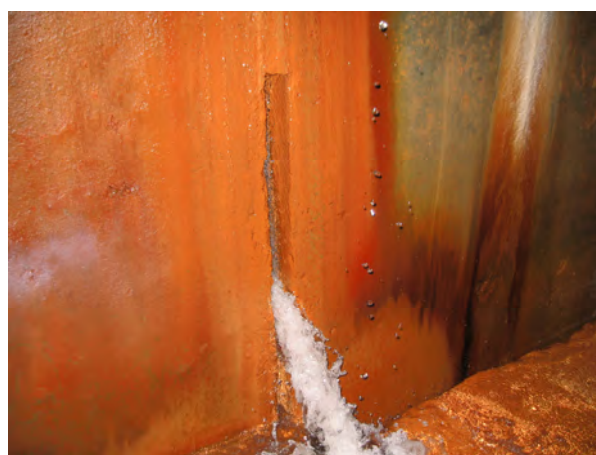
Hình 2. Nước rò qua khe co giãn đập Sê San 4 (tháng 4-2010).
