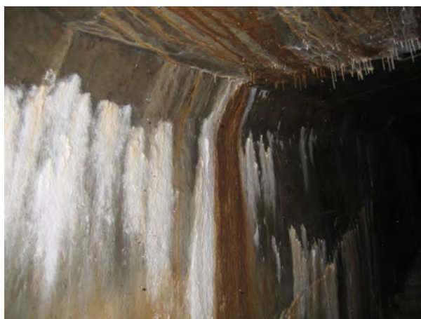
Hình 1. Tiết vôi do nước thấm vào hành lang đập Bản Vẽ (tháng 4-2011).
