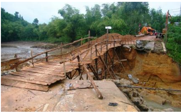
Hình 2. Đập Phân Lân 1 sau sự cố vỡ đập
