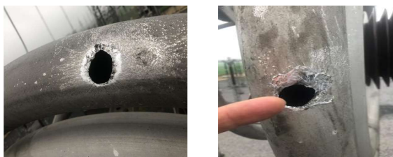
Hình 2. Hình ảnh phóng điện tại các vòng đẳng thế pha A, B
