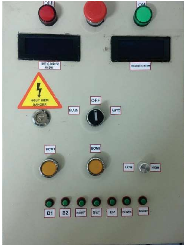
Hình 4: Tủ điện điều khiển chính
