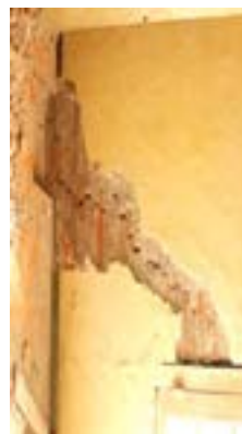
Hình 1.14. Những vết nứt tường rất phổ biến ở các công trình thuộc địa Pháp
