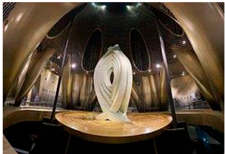
Hình 8. Hệ thống giảm chấn Tòa nhà Shanghai Tower, Trung Quốc ( https://vi.wikipedia.org )
