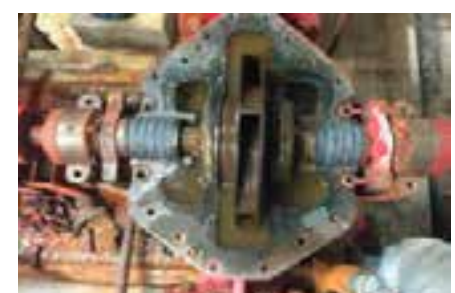
Hình 3. Bơm bị gỉ sét phía trong
