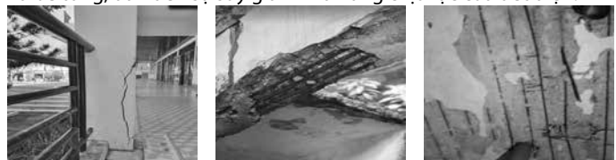
a- Cột BTCT bị nứt vỡ dọc theo cốt thép
