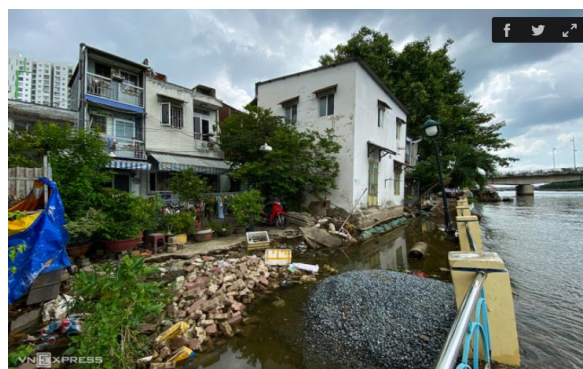
b. Sụt lún, sạt lở đoạn kè kênh Thanh Đa, TP Hồ Chí Minh (Kè tường đứng kết hợp mái nghiêng)
